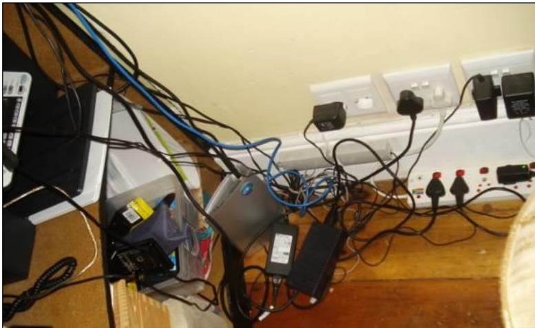
Figura 15: Linhas e cabos de energia
